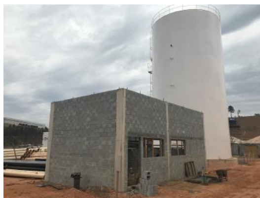
Reservatório de água e casa de bombas
