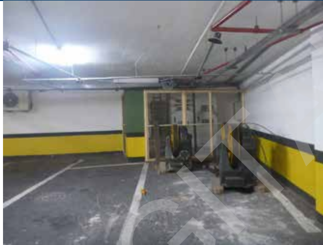
ASPECTO INTERNO DO AVALIANDO – SS - SUBSOLO – ÁREA TECNICA
